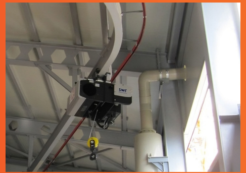
Puente grúa suspendido
