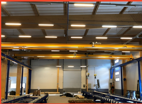
Puente grúa monorraíl
